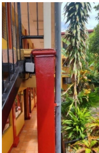
Anexo 8 – Foto. Caja de Registro para Resguardar Empalme
