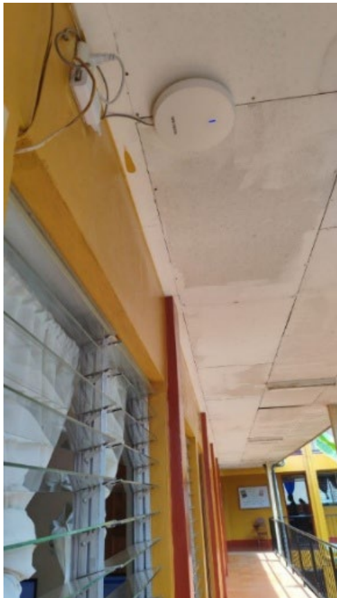
Anexo 7 – Foto. Punto de Acceso Hikvision
