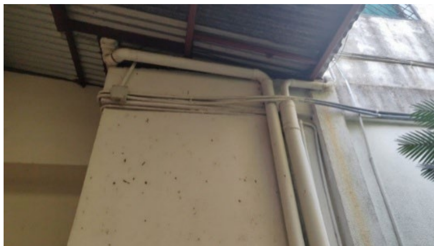
Anexo 4 – Foto. Cableado Dirigido a Casa de sor Pastora al Router
