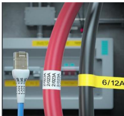
Figura 12. Etiqueta de cableado
